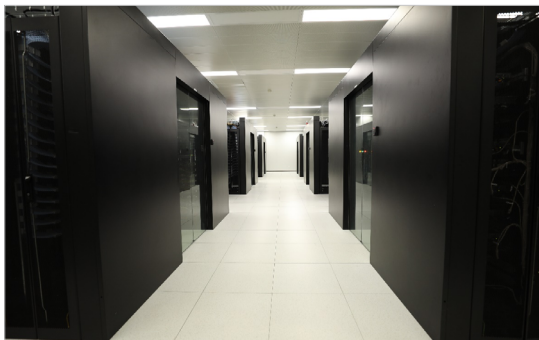
图 2 数据中心走廊
