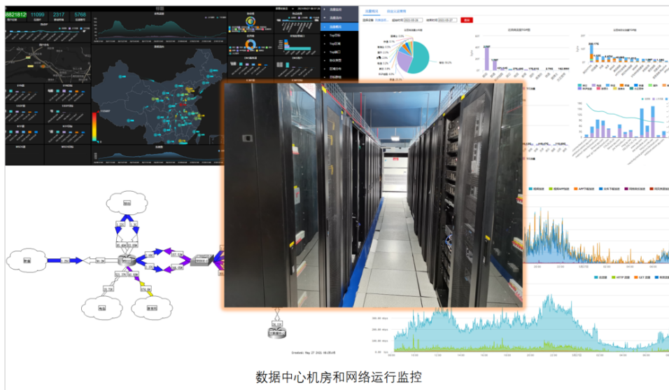
图 1 数据中心及网络运行监控平台
