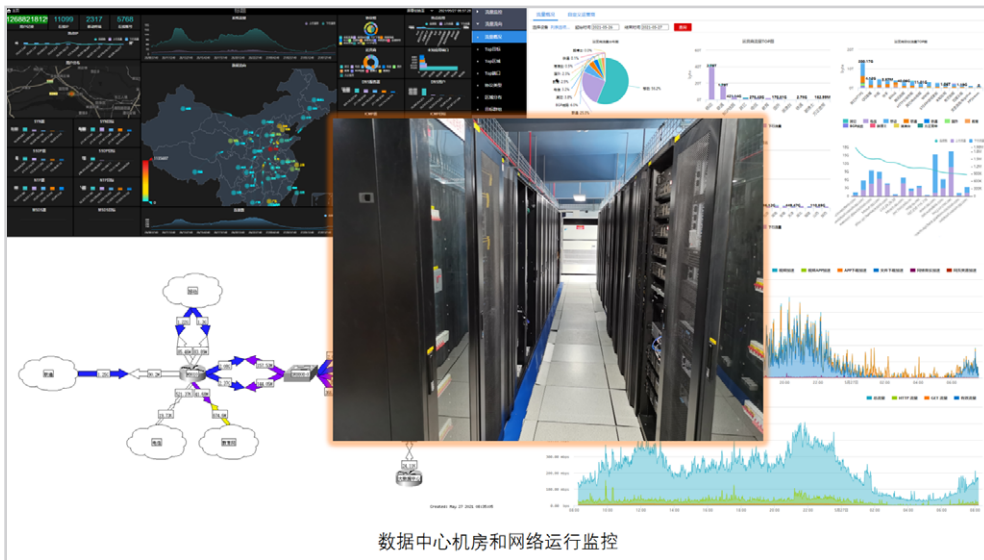
图 5 数据中心及网络运行监控平台
