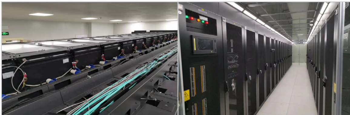
图 2 新数据中心模块化机房
