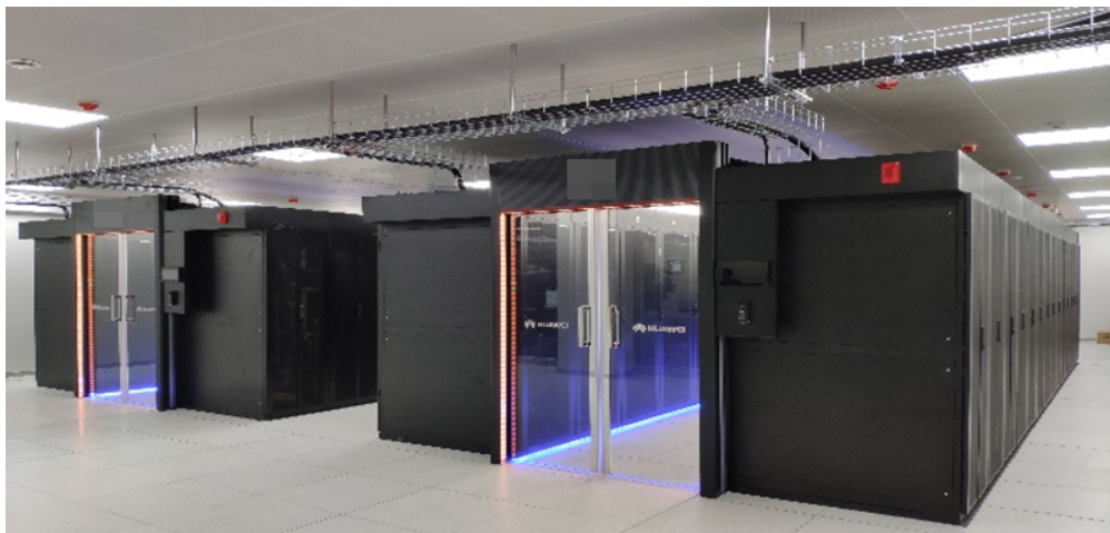
图 11 新建机房实景图
